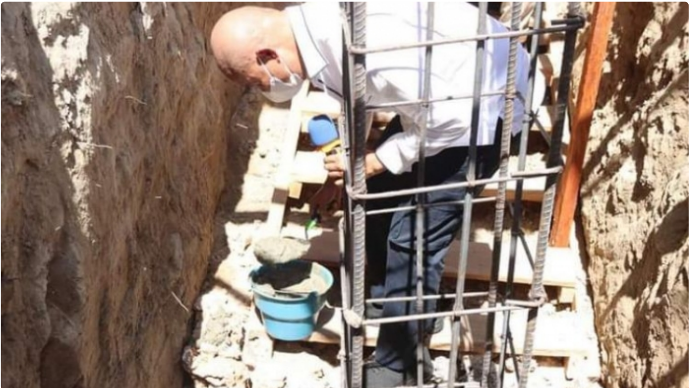
Gubernur NTT, Viktor Bungtilu Laiskodat (VBL) saat peletakan batu pertama pembangunan Gedung Kebaktian Jemaat Mizpa Tetebudale
